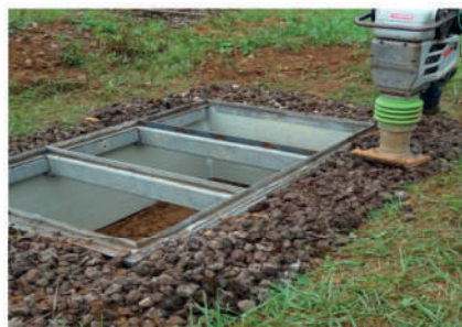
5. Die Baugrube bündig bis zur Oberkante des Stahlrahmens auffüllen und mit einem Vibrationsstamper verdichten.
