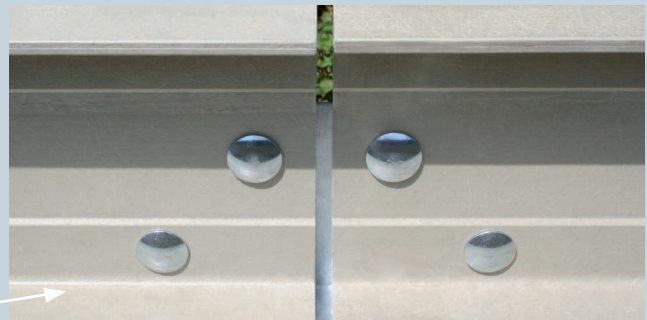
Vis à tête bombée, observé joint de dilatation
